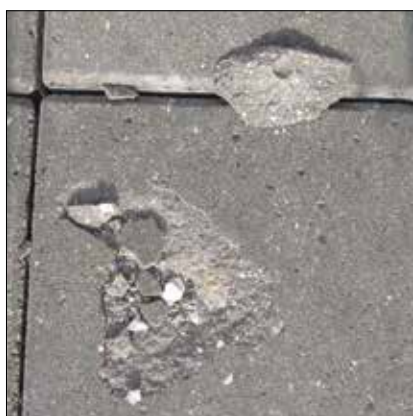
Figur 2.46. En "kalkspringer", dvs. en vandmættet kalksten, har udvidet sig i frostvejr og presset en flage af betonen.
