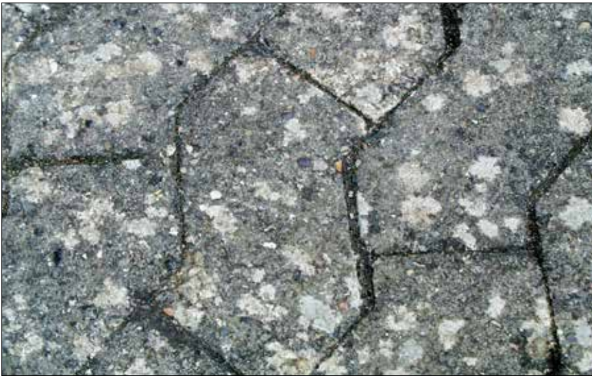
Figur 4.6. De hvide/grålige lavbevoksninger er sværere at fjerne end de grønne alger, men der findes midler der klarer dette. Her et kraftigt angreb på 25 år gamle betonsten.
