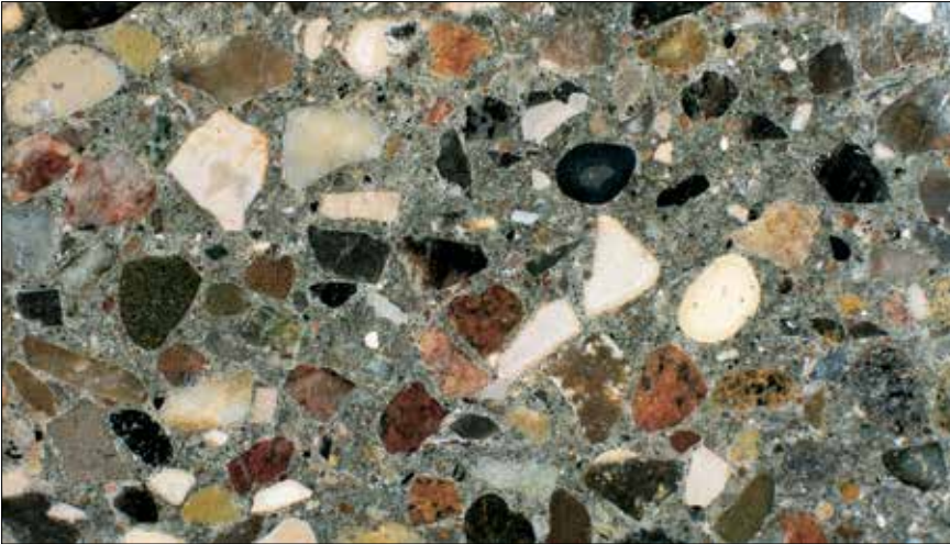
Figur 2.41. Ved at skære en betonsten over kan man bedre se og forstå hvordan den er opbygget.
