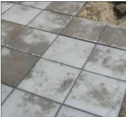
Figur 2.48. Varierende porestruktur kan give et udseende som dette, når fliserne tørrer ud efter regnvejr. Det er ikke tegn på manglende modstandsevne over for påvirkninger fra frost-tø og salt.
